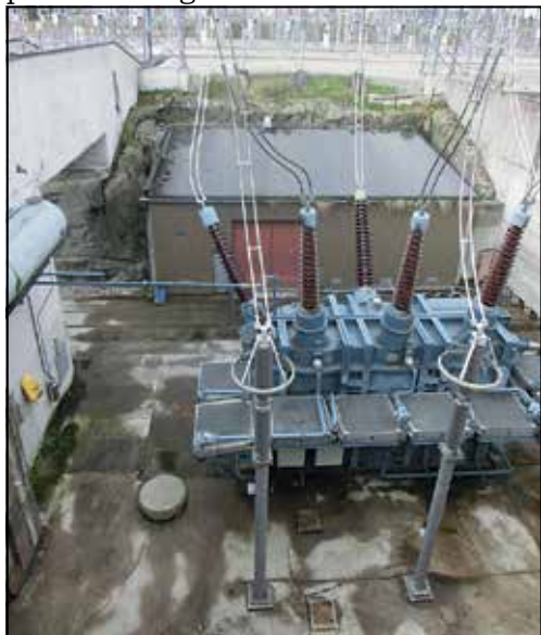
Transformatoren «T6», et begrep innen norsk kraftoverføringsmiljø. Den eneste av de opprinnelige transformatorene som er igjen på Hasle. Fotograf: Øistein Bøe
